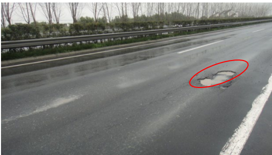
早期损害 (坑槽、车辙)
