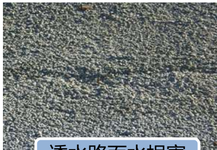
透水路面水损害
